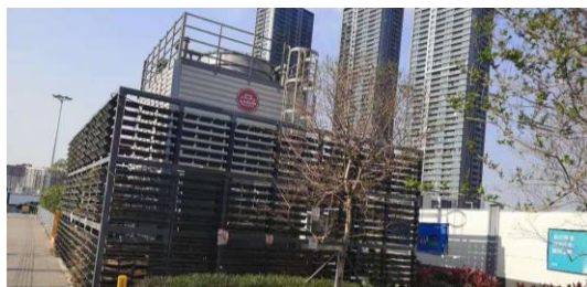
铁路公园站冷却塔
