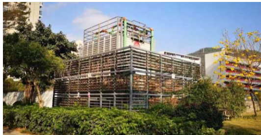
荔湾站冷却塔
