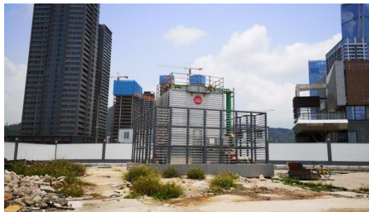
妈湾站冷却塔
