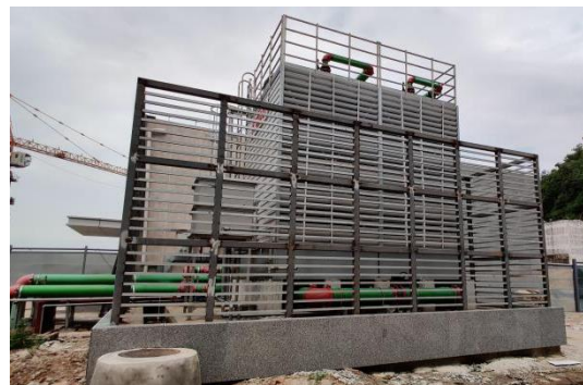
赤湾站冷却塔
