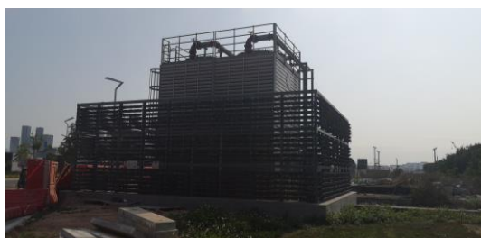
前湾公园站冷却塔
