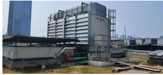
桂湾站站冷却塔
