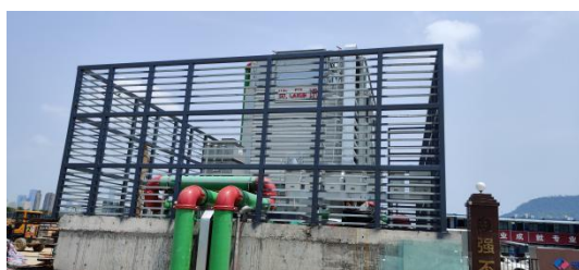
前湾站冷却塔
