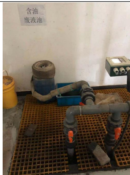
污水站含油池
