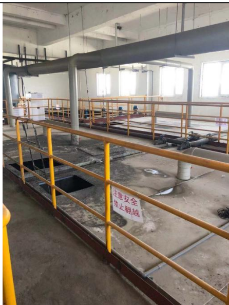
污水站生化池
