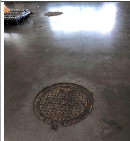
2号厂房地面含油废水收集井
