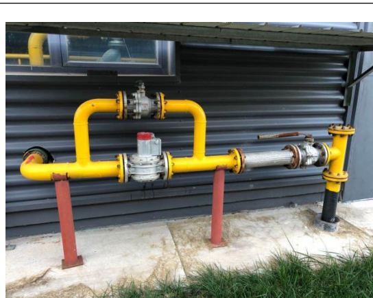
1号厂房外燃气紧急切断阀
