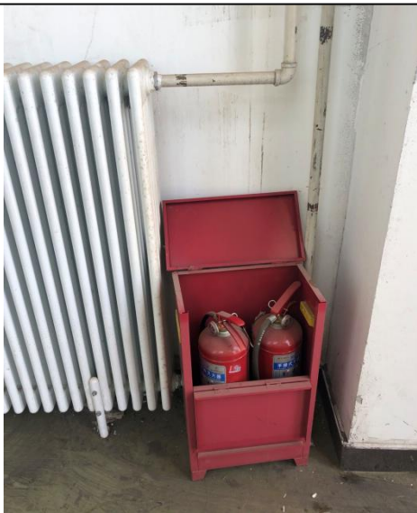
危废暂存间灭火器
