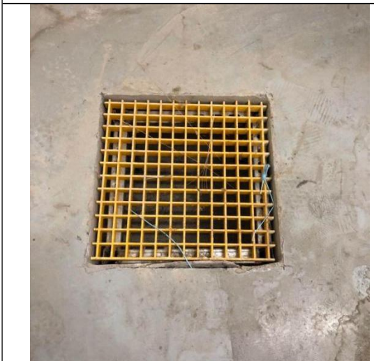
甲醇间内收集沟 0.5m×0.5m×0.5m
