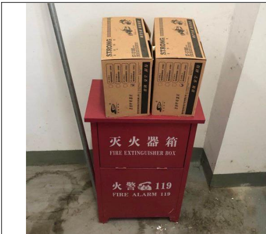
甲醇间内灭火器
