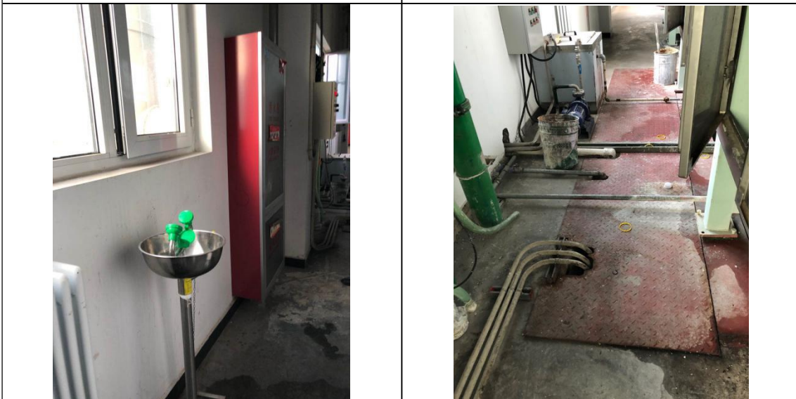
磷化间内洗眼器
