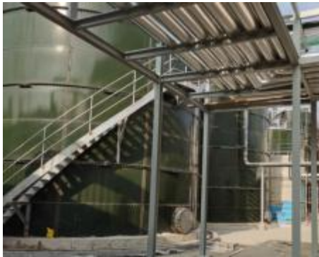
UASB 硝化、反硝化处理罐
