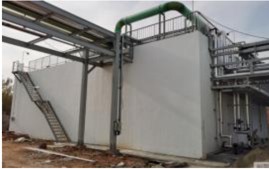
渗滤液处理系统的预处理工段
