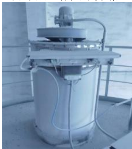
消石灰仓自带袋式除尘器
