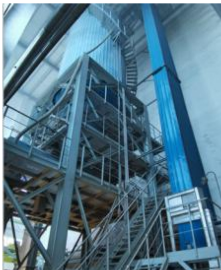
飞灰库内飞灰储罐
