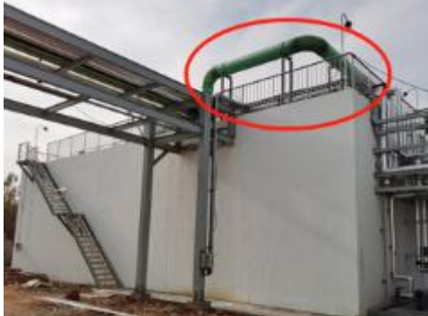
异味收集管线
