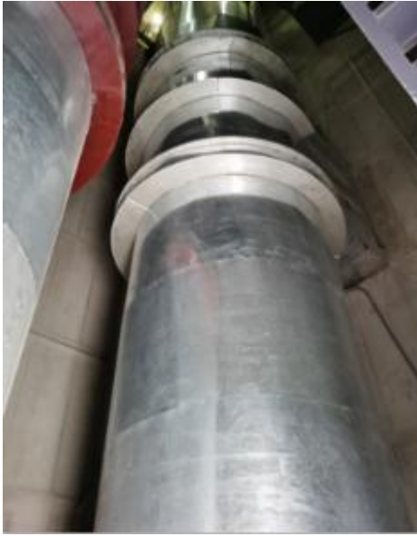
本项目焚烧烟气排气筒（三管集束之一）
