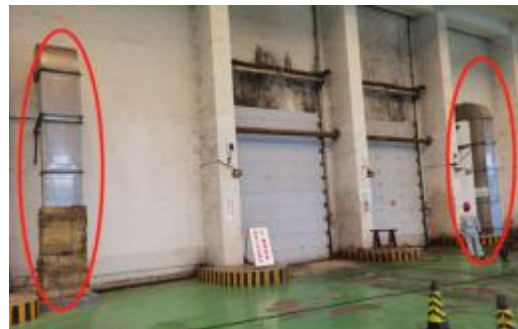
异味收集管线
