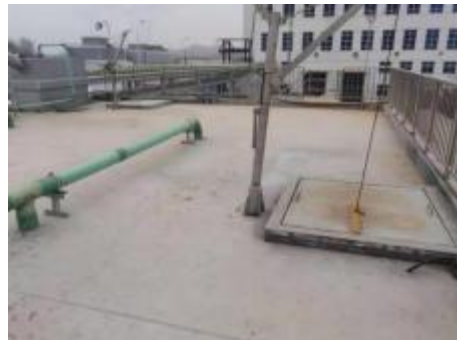
渗滤液调节池顶部密封+臭气管道
